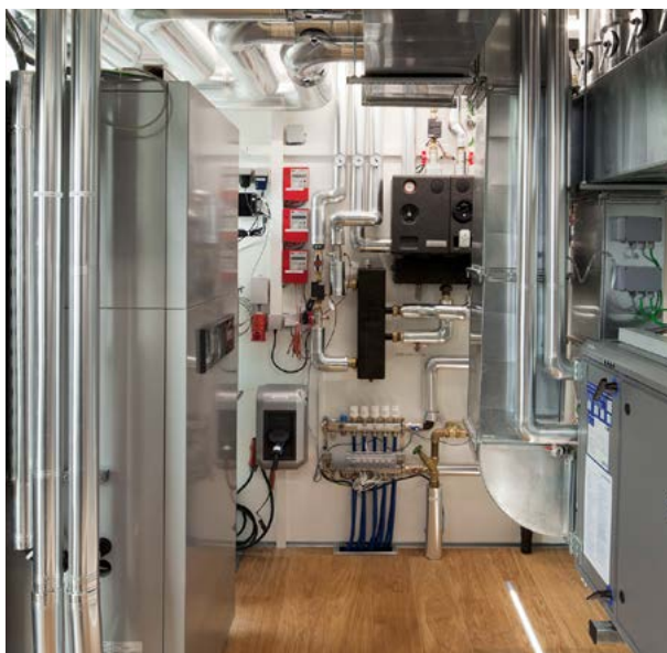
Blick in den Technikraum
